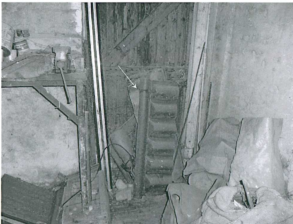
Foto 4: Gezicht op een aantal asbestverdachte golfplaten.
