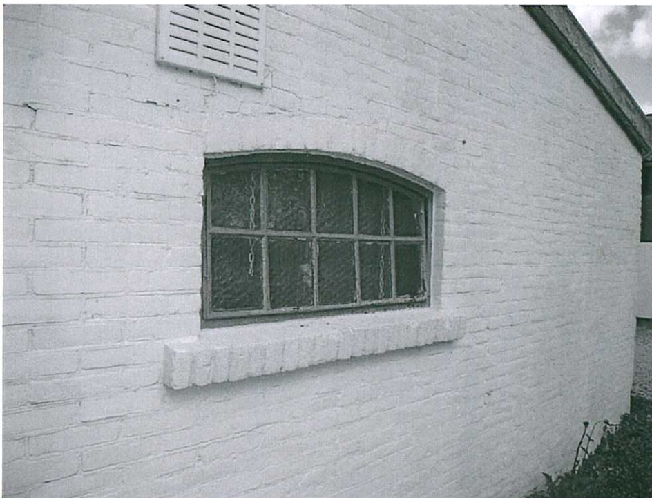
Foto 2: Gezicht op de niet asbesthoudende stopverf in één van de ramen.
