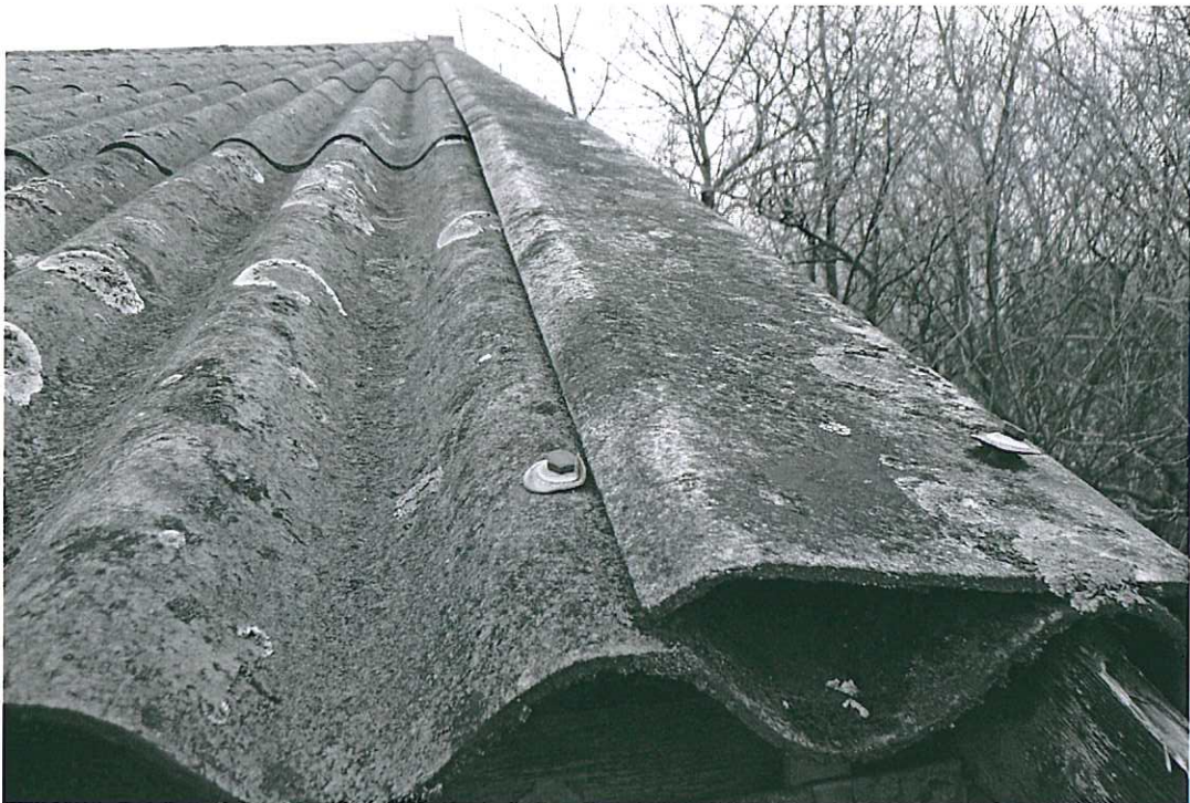
Foto 2: Gezicht op de asbesthoudende golfplaten en kantprofielen.
