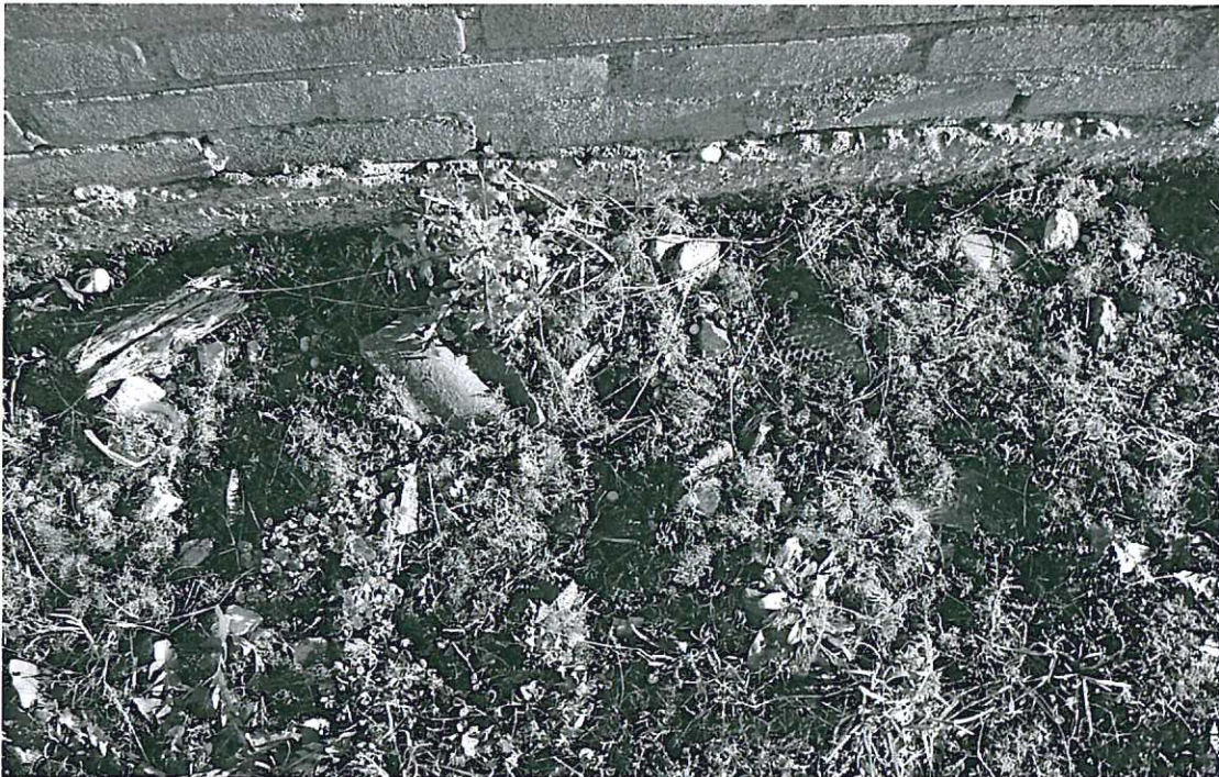
Foto 4: Gezicht op fragmenten asbest langs de landbouwschuur.
