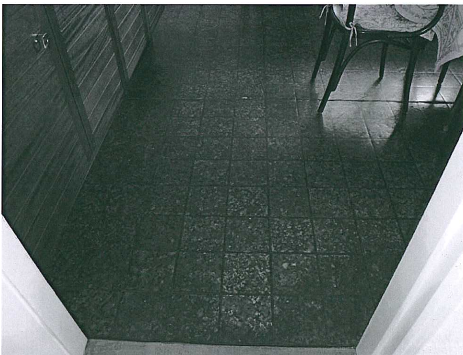
Foto 3: Gezicht op het asbesthoudende vloerzeil in de keuken.
