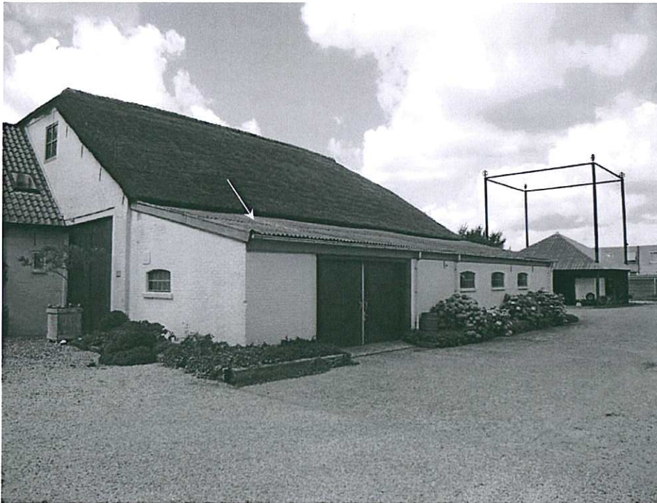
Foto 1: Gezicht op de asbesthoudende golfplaten op een deel van het dak.
