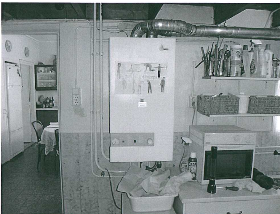
Foto 6: Gezicht op de mogelijk asbesthoudende cv-ketel.
