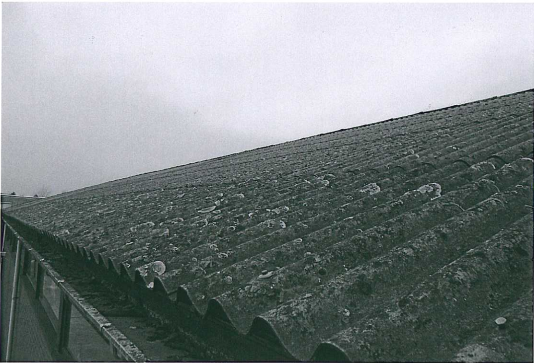
Foto 1: Gezicht op de asbesthoudende golfplaten op het dak van de landbouwschuur.
