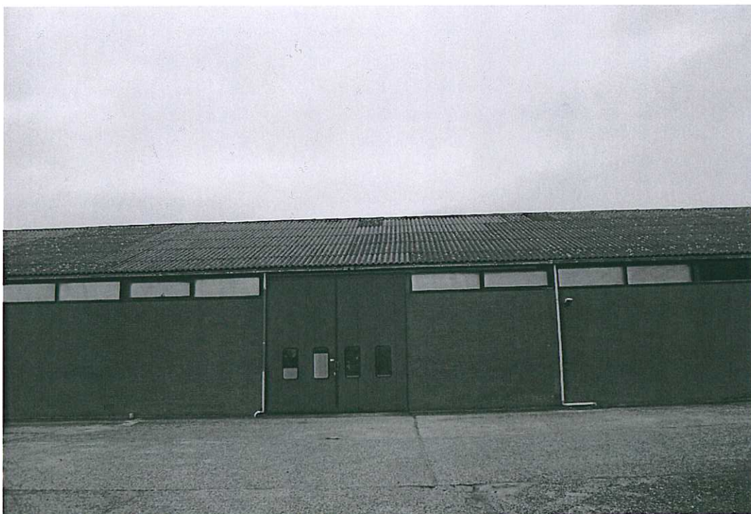
Foto 3: Gezicht op het asbesthoudende dak van de landbouwschuur.
