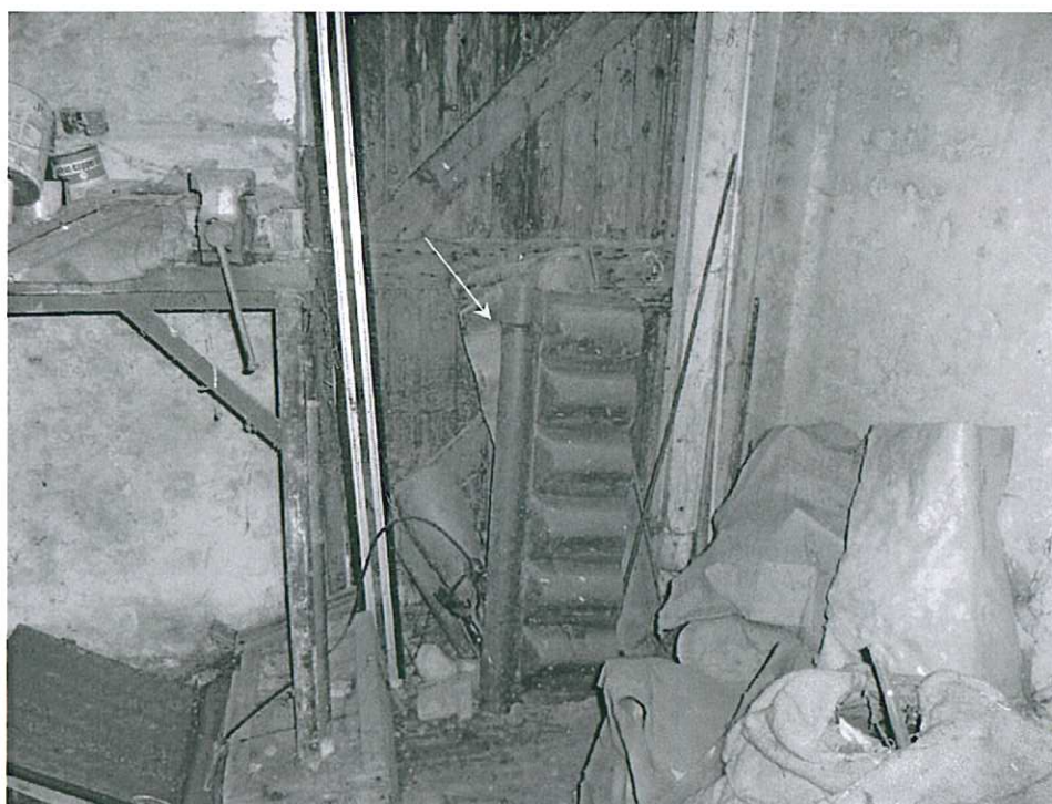
Foto 4: Gezicht op een aantal asbestverdachte golfplaten.
