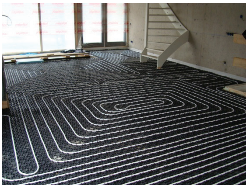
Afb: Een Lage Temperatuur Verwarming (LTV) kan als wand en als vloerverwarming worden aangelegd
