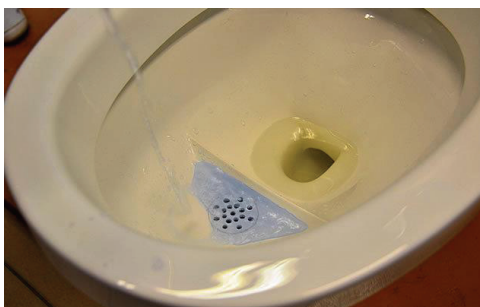
Afb: In de aangesloten woningen wordt geen standaard toilet geplaatst maar een Vacuüm toilet
