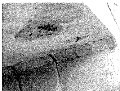
Foto 2: Kwaliteit Basis. Niet direct zichtbare betonschade komt op een beperkt aantal locaties voor.
