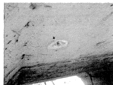
Foto 3: Kwaliteit Basis +. Een incidentele betonschade komt voor. Het algehele beeld is goed.
