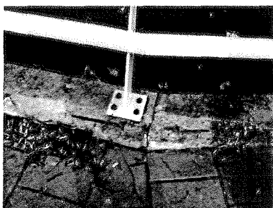
Foto 1: Kwaliteit Extensief. Er is direct zichtbare, plaatselijke betonschade.
