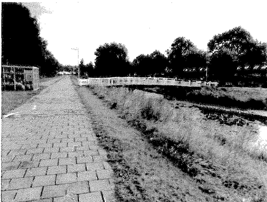
BR0270: Overzichtfoto. Onderhoudsstaat: 'Slecht' (score: 5).
