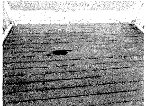
Schade: De dekdelen zijn aan de onderzijde aangetast door houtrot en witte schimmels. Door de aantasting is één dekdeel bezweken, waardoor er een gevaarlijke situatie is ontstaan.
