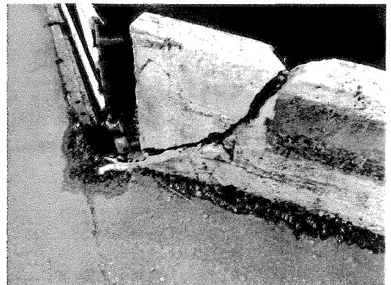
Schade: De brug vertoont structureel betonschade door ouderdom en aanrijdingen. De brug is door zijn slechte staat opgenomen op de VOR lijst voor 2013-2017.
