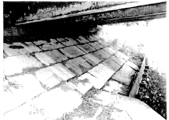
Schade: Aan de onderzijde is lichte begroeiing aanwezig en het talud is lichtelijk uitgespoeld waardoor er verzakking aanwezig is. Verder verkeert de brug in een zeer goede staat.
