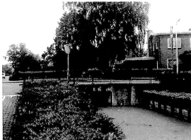
Schoolstraat, Bergambacht (gemeentelijk) Bouwjaar 1955 Betonnen plaat met betonnen keerwanden op houten palen
