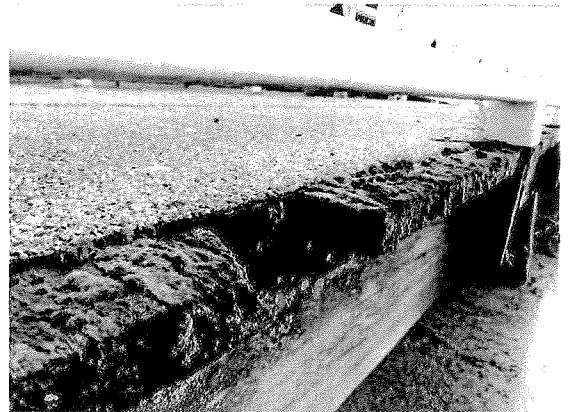
Schade: Dekdelen zijn aangetast door houtrot. Dit wordt veroorzaakt doordat er een slijtlaagmat op aangebracht is, waardoor het hout vochtig blijft.
