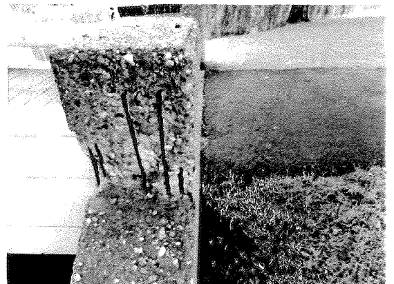
Schade: De betonnen schampkanten vertonen structureel betonschade met blootliggende wapening. Dit is veroorzaakt door aantasting van het beton waardoor er een te lage dekking op de wapening is ontstaan.
