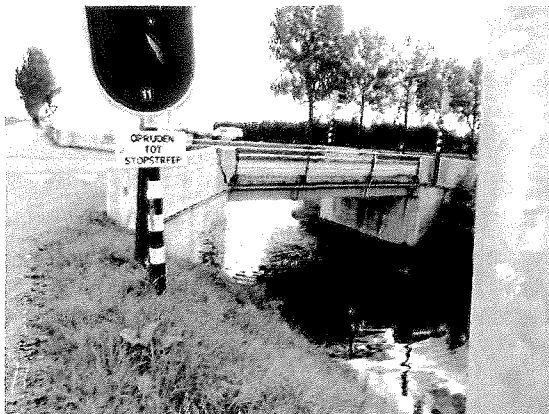
BR0010: Overzichtfoto. Onderhoudsstaat: 'Slecht' (score: 5).
