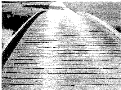
Foto 7: Kwaliteitsniveau Extensief. Grote plekken van de slijtlaag zijn verdwenen, brug is wel voldoende stroef.
