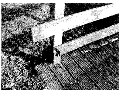
Foto 11: Kwaliteitsniveau Basis. Plaatselijke schades aan onderregels van leuning kunnen voorkomen.
