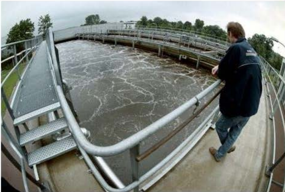
De afvalwaterzuivering van Schiphol
