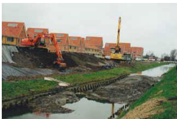
Figuur 18 Opbarsting bij doorbreken deklaag
