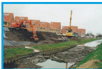
Op en nabij plekken waar de bodem is verstoord ontstaan regelmatig wellen en opbastingen van brak water. Dit gebeurde bijvoorbeeld bij de bouw van Getsewoud.
